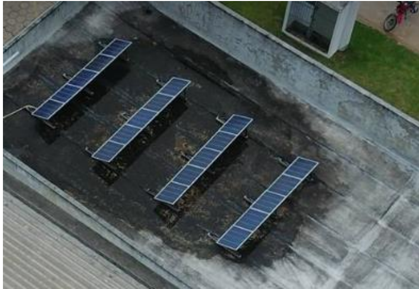
Figura 28 – Foto dos módulos fotovoltaicos em cima do Prédio do Bloco de Engenharia Elétrica.
