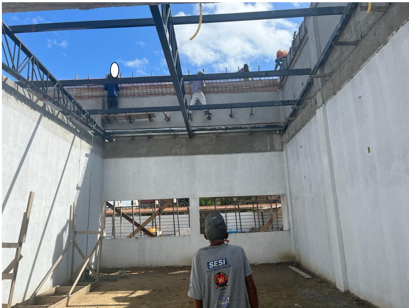
Foto 3 – armação da viga e laje da cobertura. Observação: descumprimento das normas de segurança
