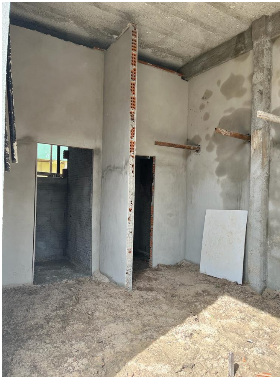
Foto 36– reboco interno (25 de abril de 2023)
