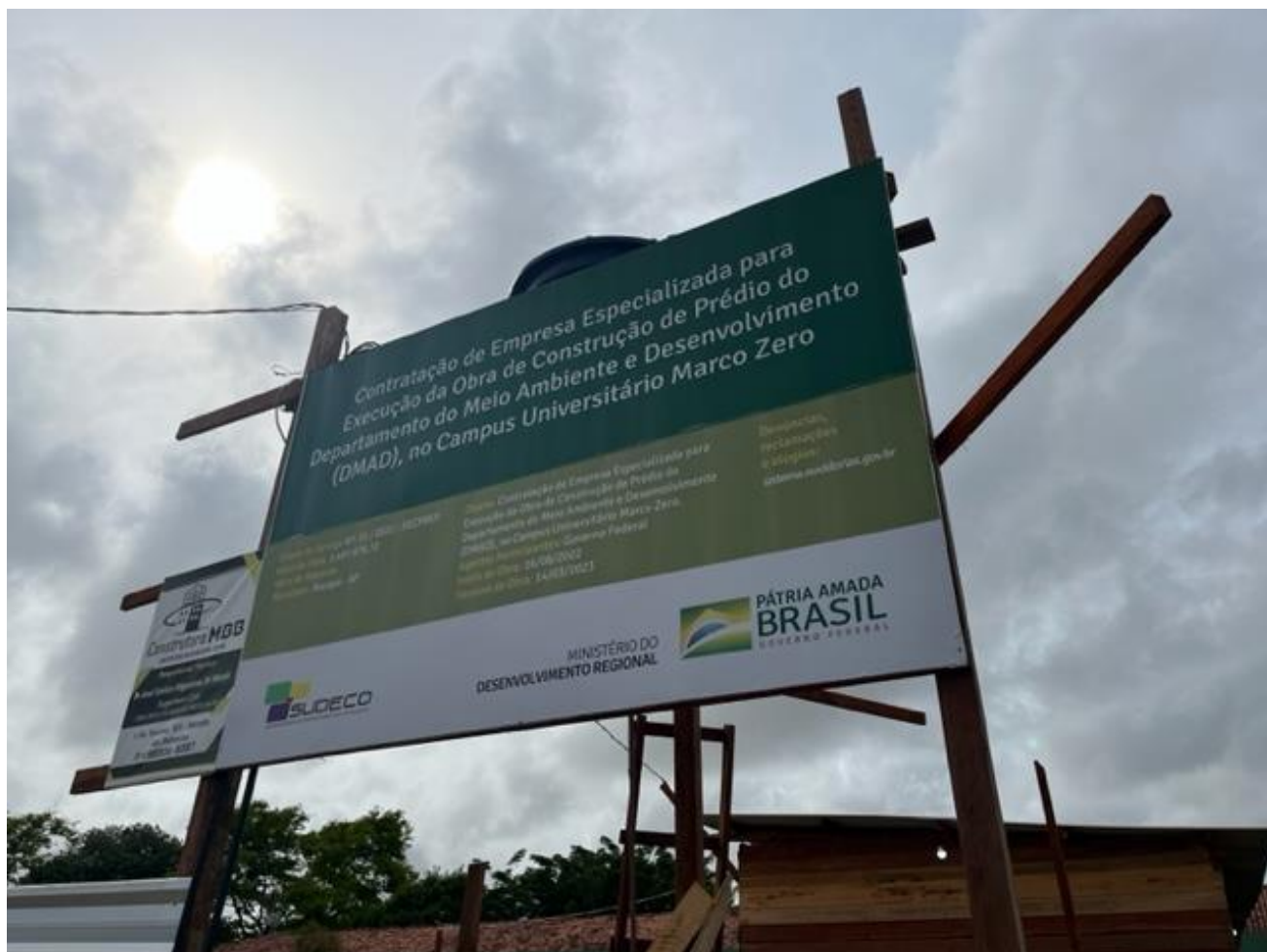
Foto 10 – placa da obra pendente de correção
