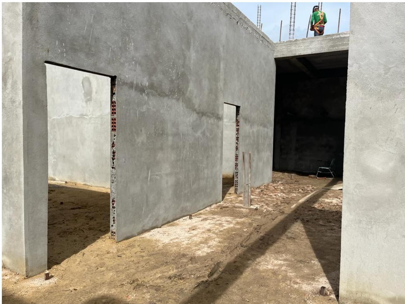
Foto 32 – reboco interno (25 de abril de 2023)
