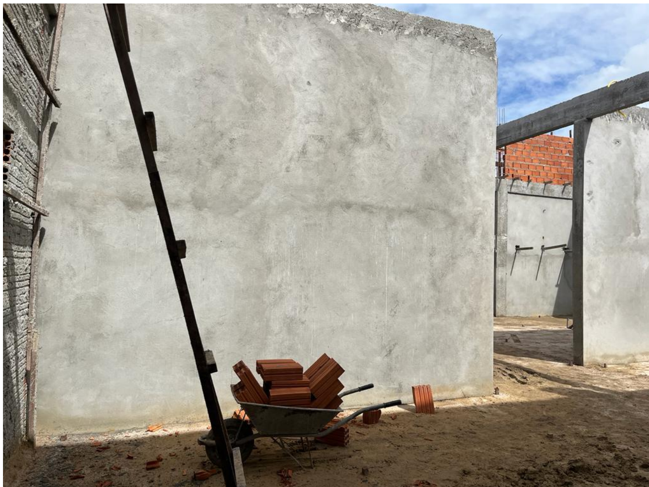
Foto 34 – reboco interno (25 de abril de 2023)
