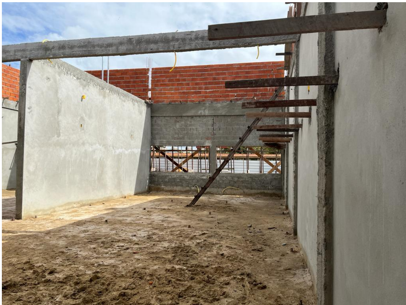
Foto 35 – reboco interno (25 de abril de 2023)
