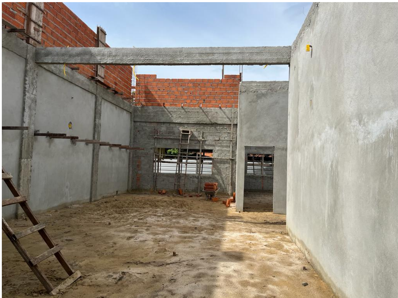
Foto 32– reboco interno (25 de abril de 2023)
