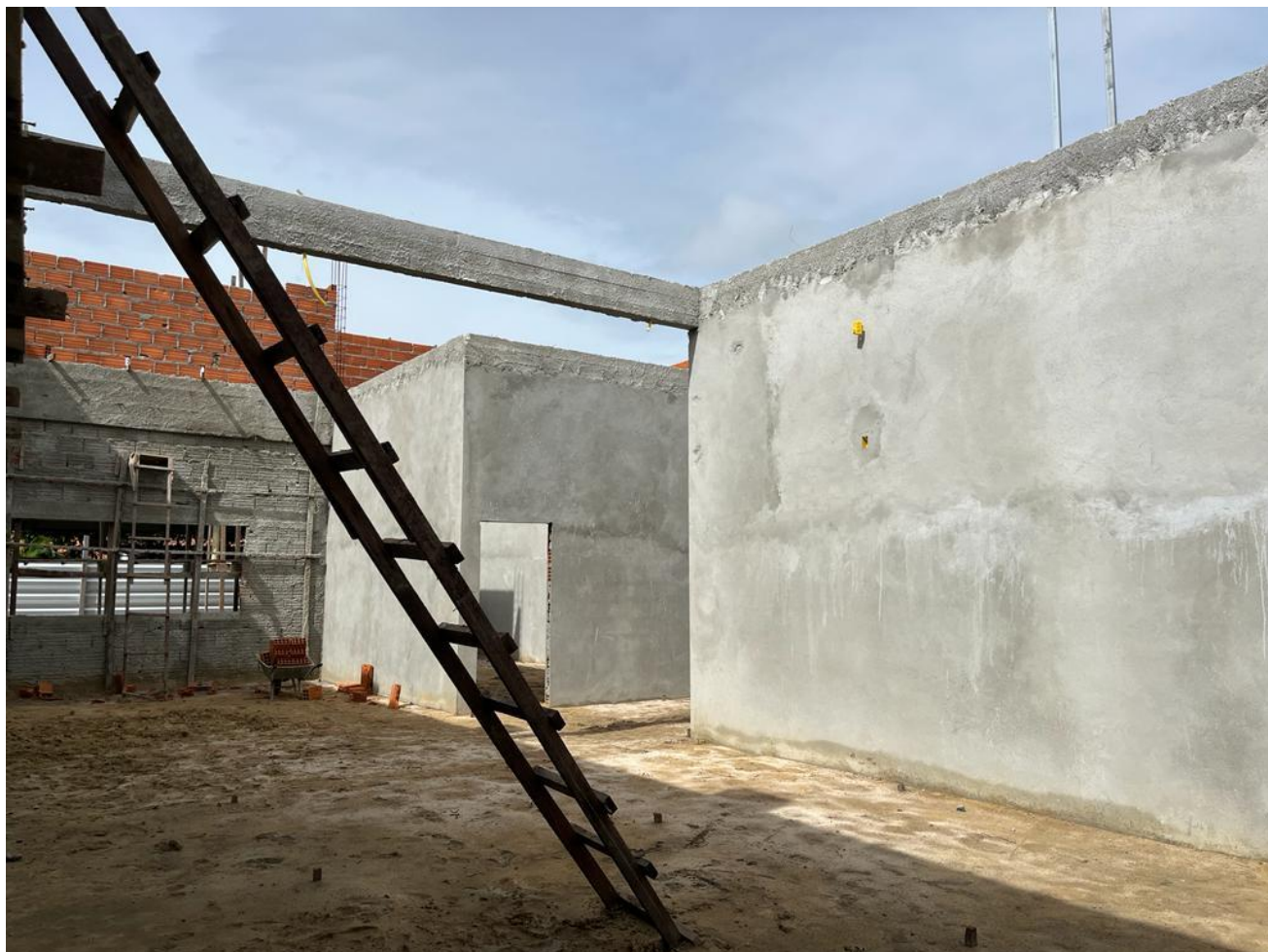
Foto 31 – reboco interno (25 de abril de 2023)
