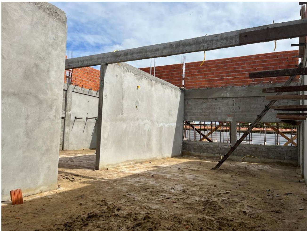
Foto 33 – reboco interno (25 de abril de 2023)
