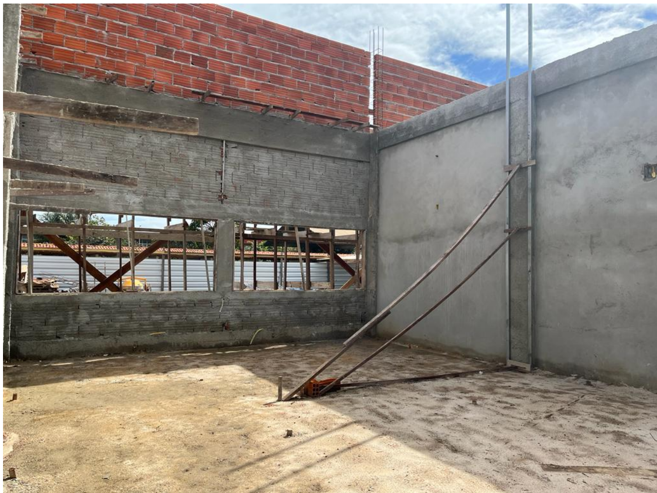
Foto 37 – reboco interno (25 de abril de 2023)
