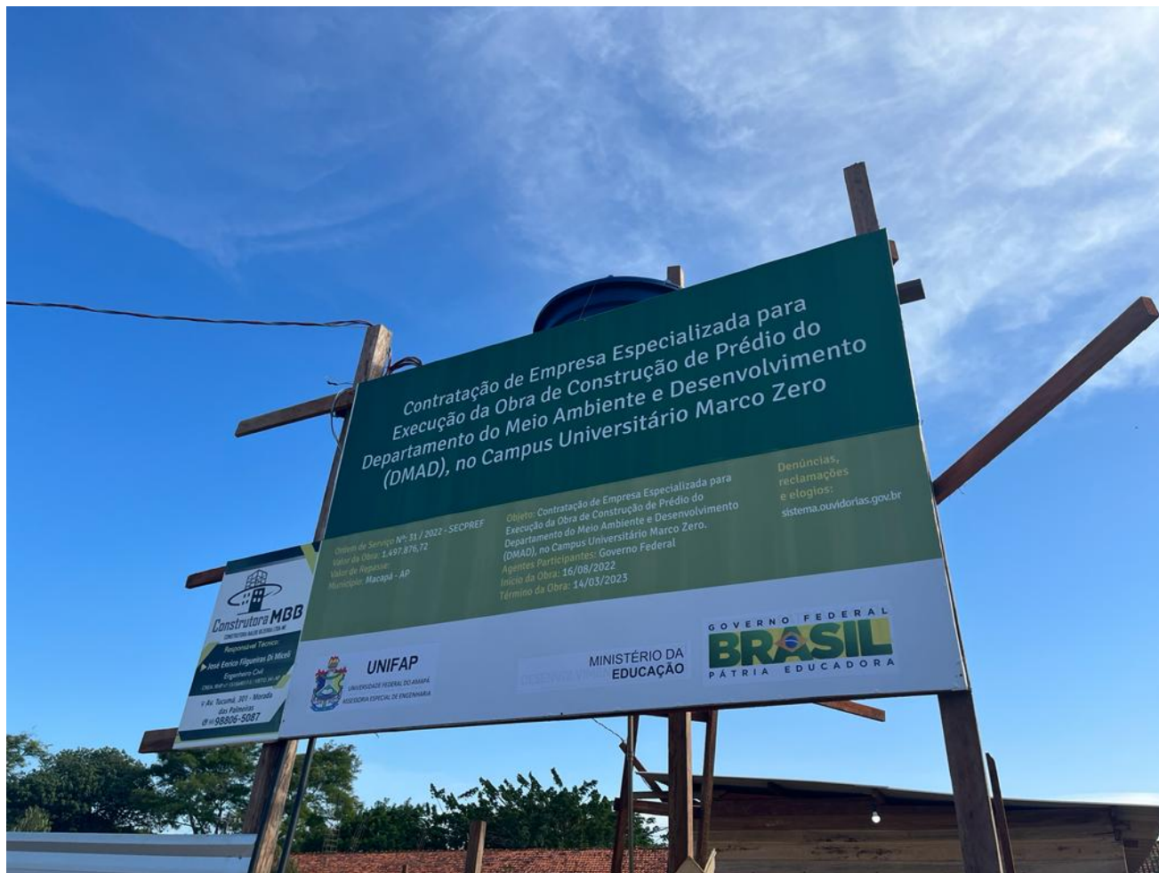
Foto 18 – correção da placa da obra 12.12.2022
