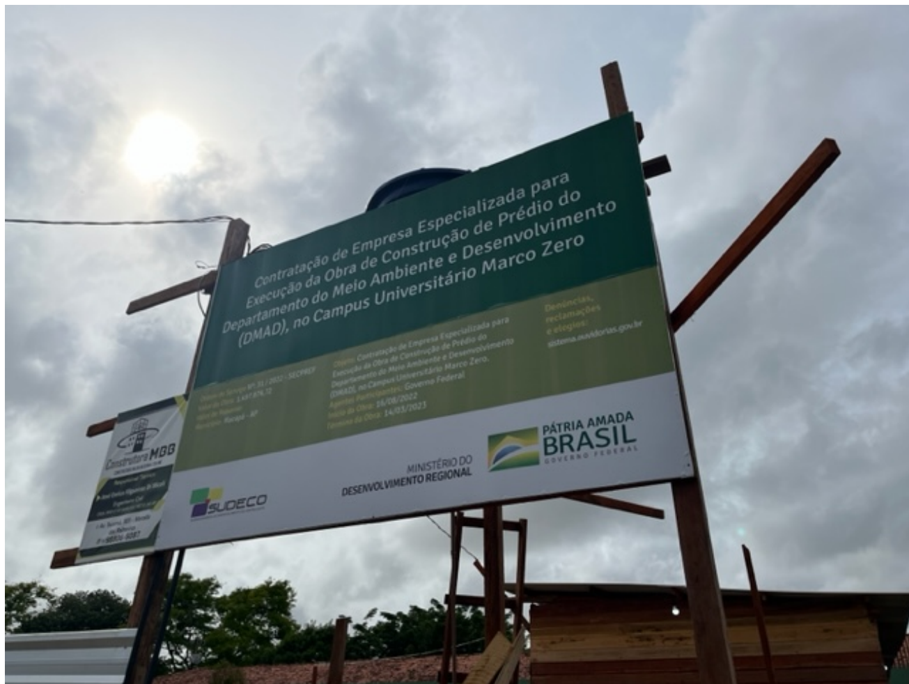
Foto 10 – placa da obra pendente de correção
