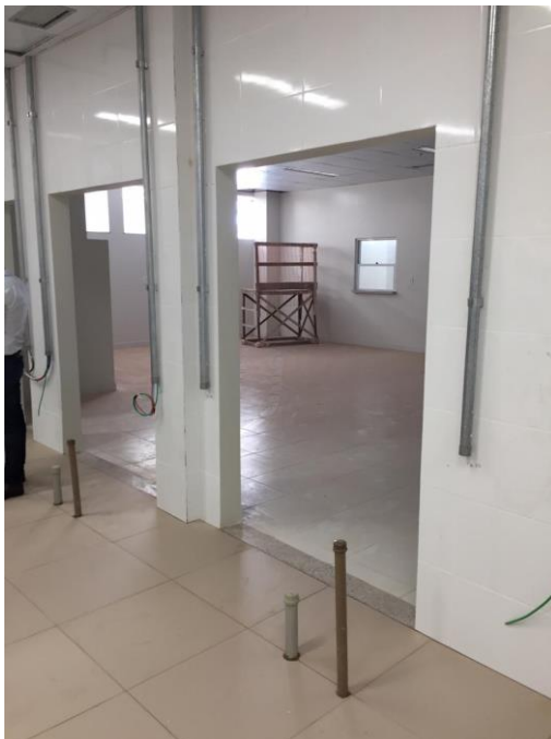
Figura 42: Local de instalação
