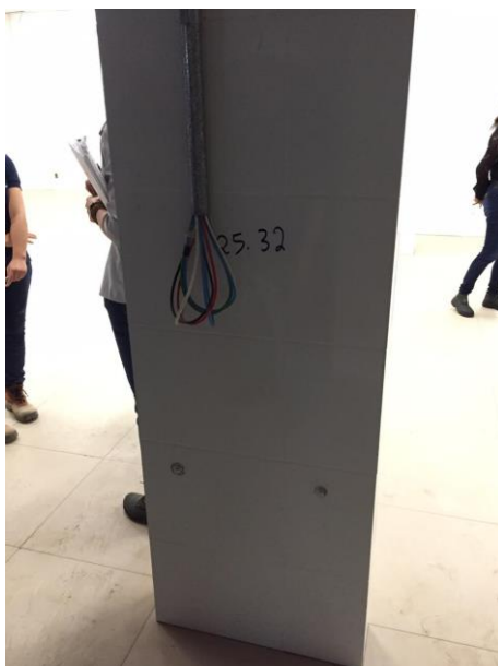
Figura 44: Local de instalação
