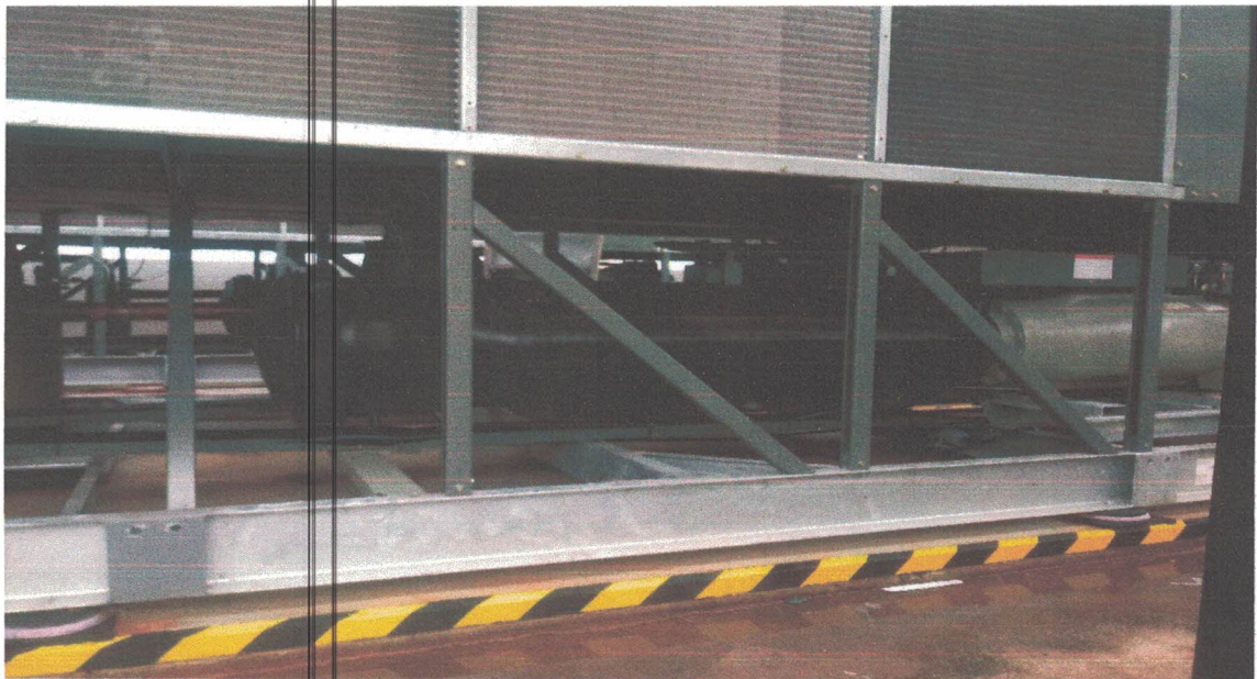
Visão lateral chillers.
