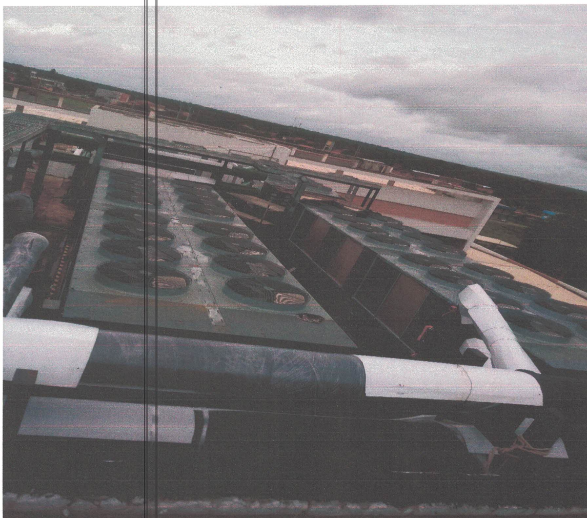
Visão superior do chillers.
